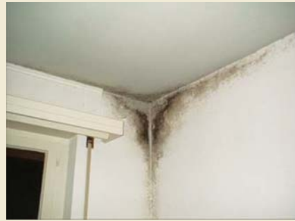
Ponte termico colpito dalla crescita di muffe e relativo termogramma (in alto)
